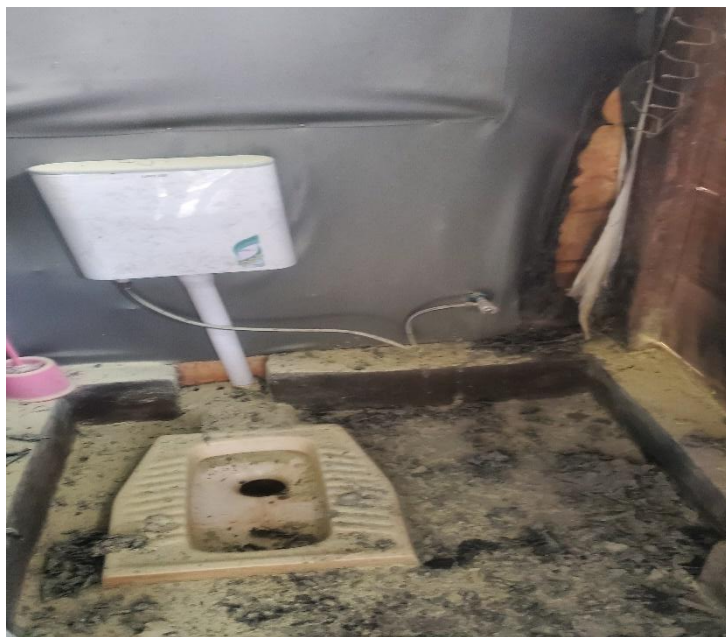
Incendie criminelle au CTE Kitatumba dans le Nord-Kivu
